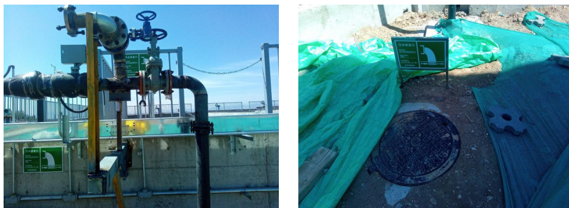
图 3.2-1 生产废水排放口（左）、生活污水排放口（右）
